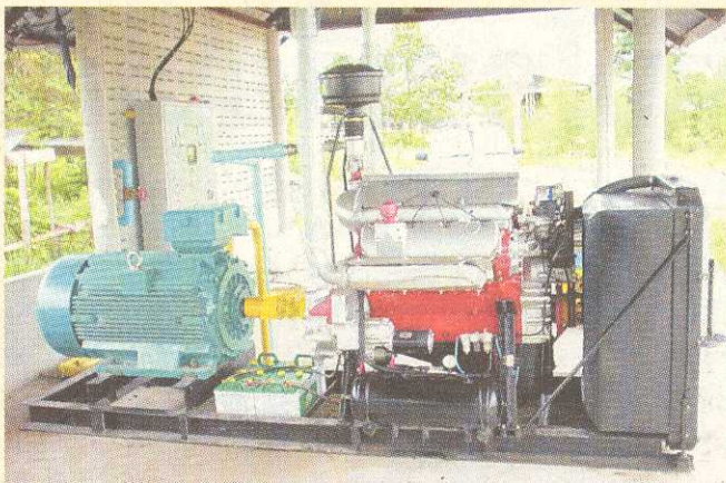
เครื่องกำเนิดไฟฟ้าโดยใช้ก๊าซชีวภาพ ระบบซีดีไอ ที่สามารถผลิตพลังงานไฟฟ้าได้ 110 กิโลวัตต์
